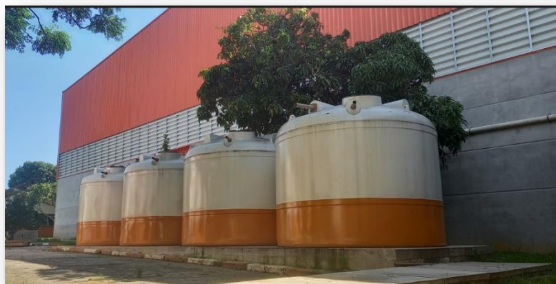
Tanques para captação de águas de chuva Matriz-SP
