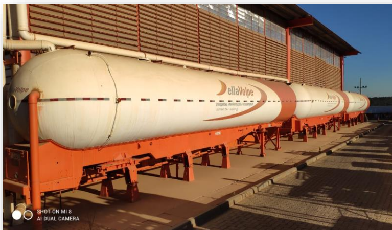
Tanques para captação de águas de chuva Contagem-MG
